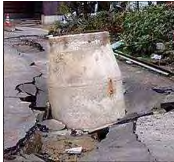
マンホール浮き上がり
